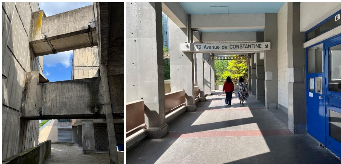
Passerelle dans la résidence « Le Zodiaque » dans le quartier des Géants / galerie entre l'ENSAG et la résidence Castatelles dans le quartier des Baladins
